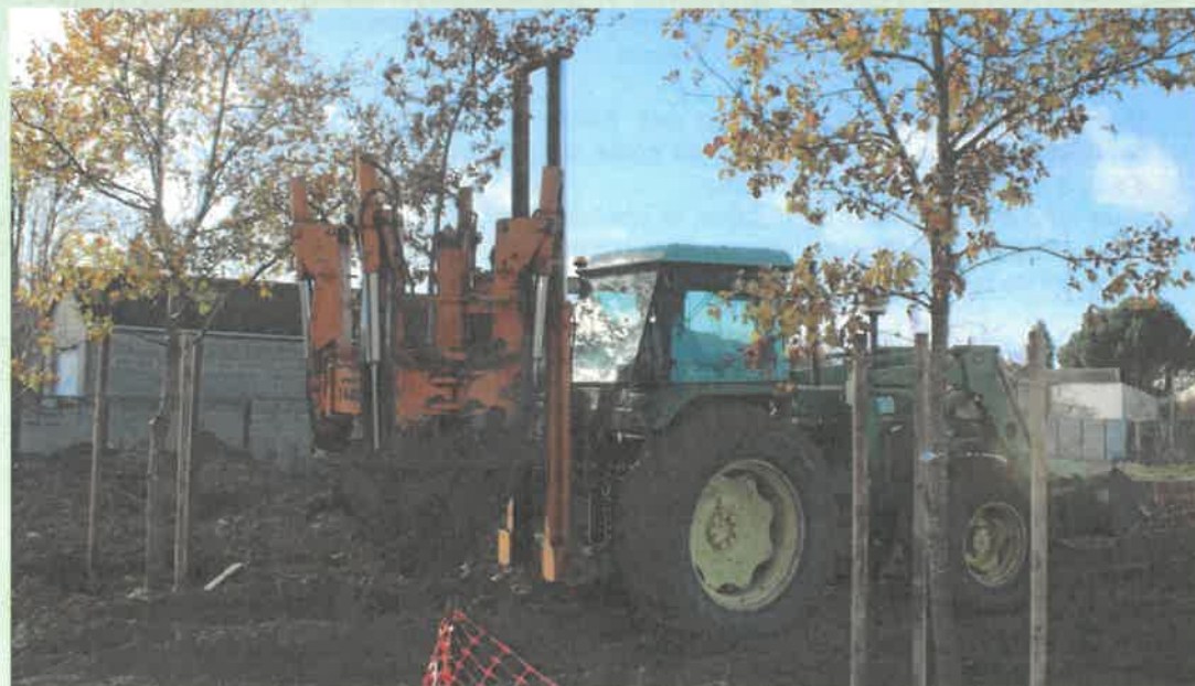
Transplantation d'arbres préexistants vers les espaces verts de la future zone d'habitat, lors de la réalisation de la tranche 1 - © NEXITY
